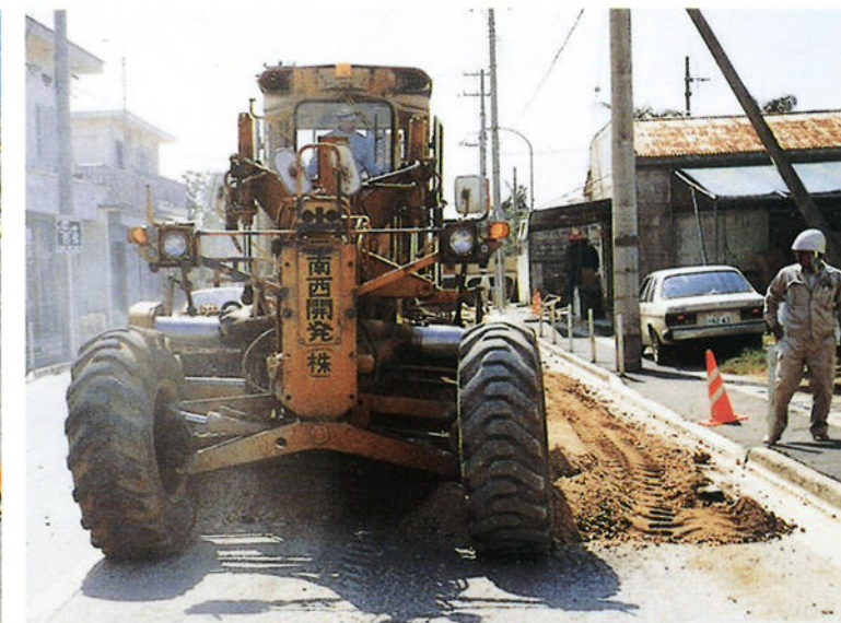
路面破碎状況
